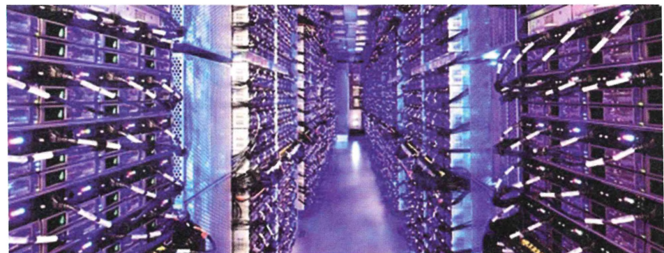
FIGURA 7 Un data center con armadi rack per i server
